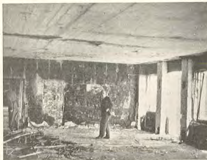
Fig. 22. Betonbygning efter brand (Ingeniorhuset).
