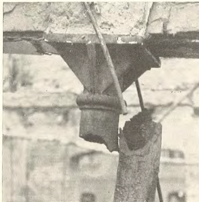
Fig. 13. Støbejernsøjle sprængt under brand.
