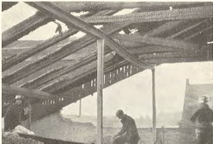
Fig. 12. Gavl væltet af temperaturudvidet stålbjælke.
