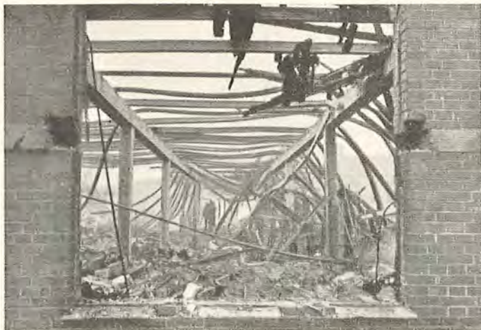
Fig. 14. Beton og stål efter brand.
